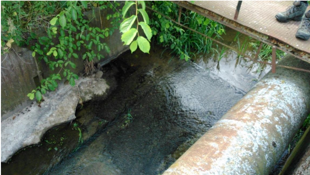
Figur 8 Gjuten bottenplatta vid platsen för dämning och intag av vatten till sockerbruket uppströms Jordbergabron. Röret till höger i bild är en del av en utloppsränna från den södra dammen.
